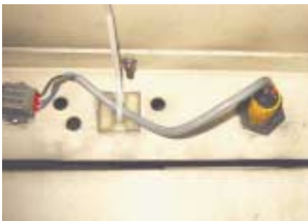
Bild 4: Strömungswächter montiert hinter einem Kühlluftgebläse im Triebkopf
